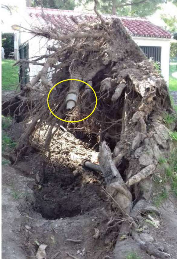
Fotografía nº3. Detalle tubería incrustada.
